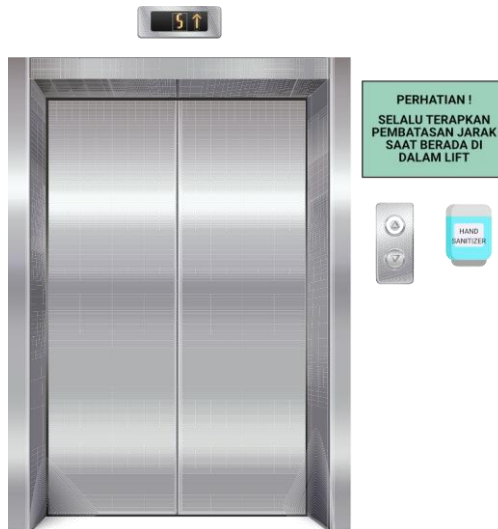
Gambar 8. Peringatan di pintu masuk lift
